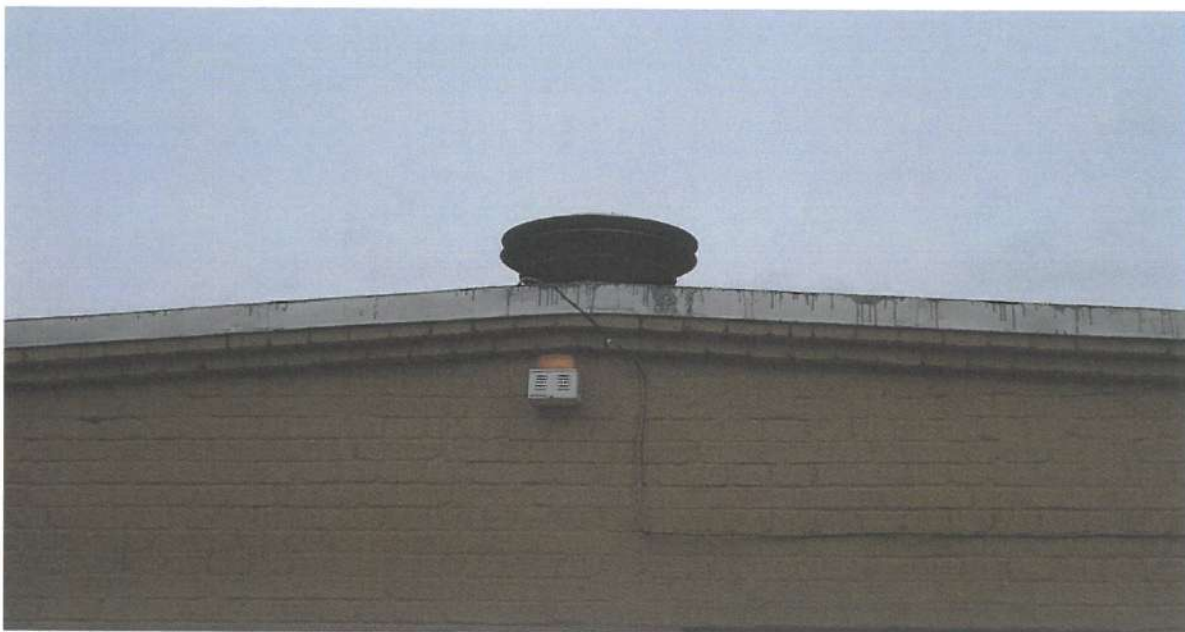
3.1.attēls Trauksmes sirēna uz administratīvās ēkas jumta
