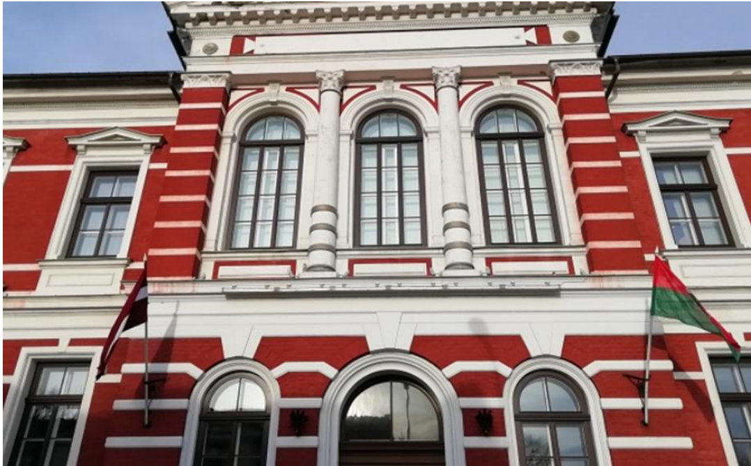
2.attēls. Ēkā, Rožu ielā 6 - arhitektūras piemineklim atbilstoši ozolkoka oderlogi, kādi bija raksturīgi 19. un 20. gadsimta mijā būvētajām ēkām.
